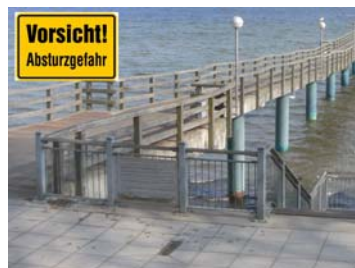
Hoffentlich mit im Haushalt? Die Seebrücke in Wismar ist seit Mai 2014 gesperrt. Das Gelände ist marode. Zur Saison 2015 soll es erneuert sein.
